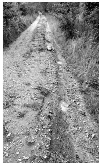
Poškozená cesta při povodních
